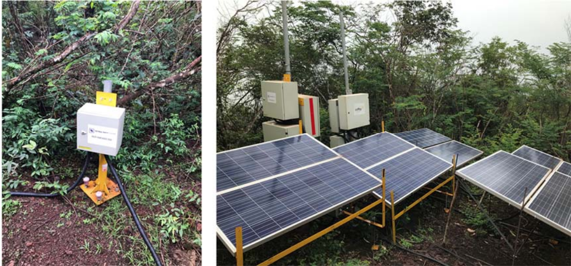
Figura 3.13 - Estações de alimentação dos equipamentos de monitoramento sistemático da cavidade N4E-0022.
