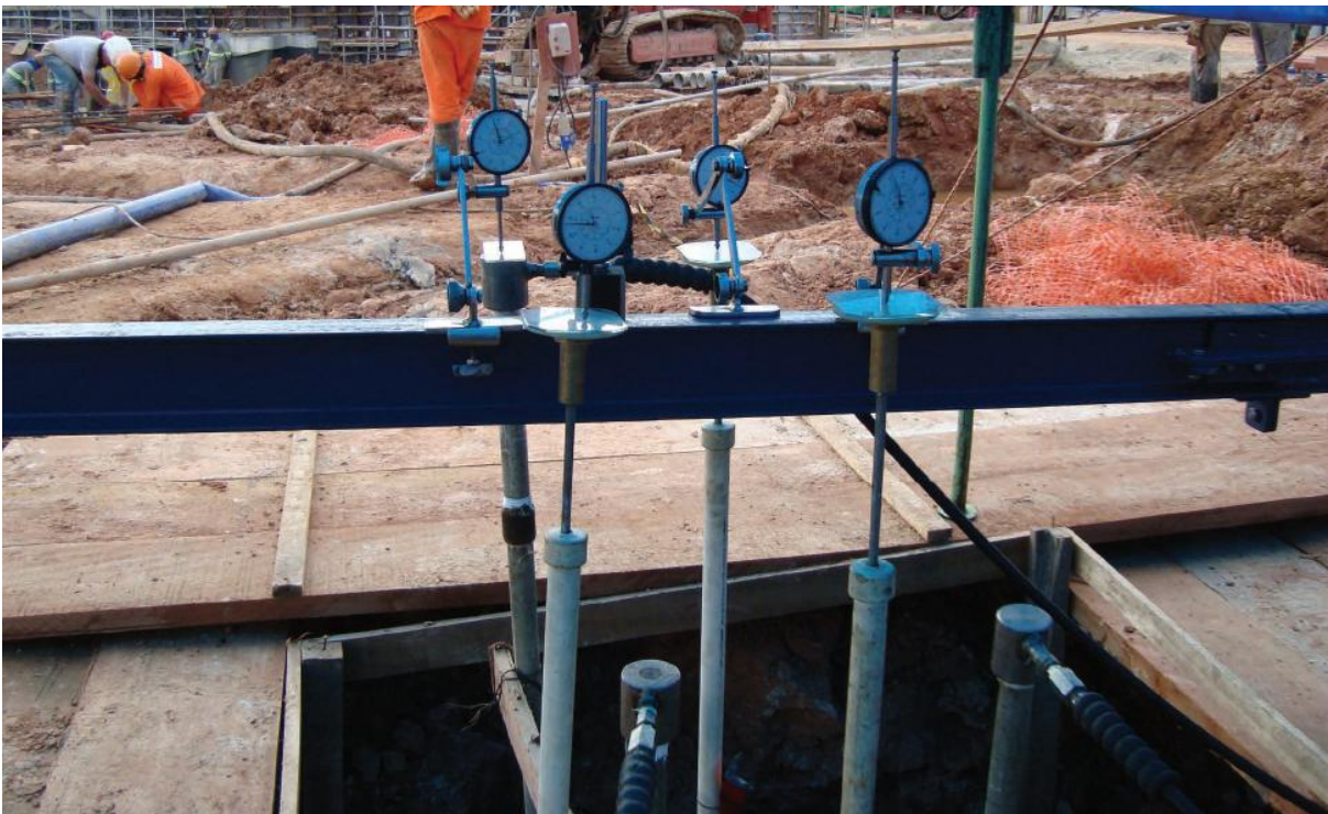
Figura 2.17 – Deflectômetros mecânicos apoiados em viga de referência, sendo um para medição do deslocamento do topo da estaca e os outros três, para telltales (fonte: cedido à pesquisadora).
