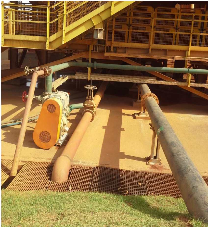
Figura 5-9 – Tubulações e caixa de passagem para conduzir os rejeitos de bauxita lavada para seu lançamento na barragem - Unidade Mirai (Acervo pessoal, fev./2016).
