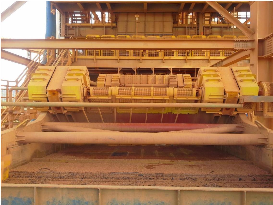
Figura 5-7 – Sistema de peneiramento - Unidade Mirai (Acervo pessoal, fev./2016).
