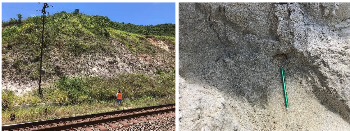
Figura 5.7 – Vista panorâmica do talude do km 518+790 (a esquerda), e em detalhe (a direita)
