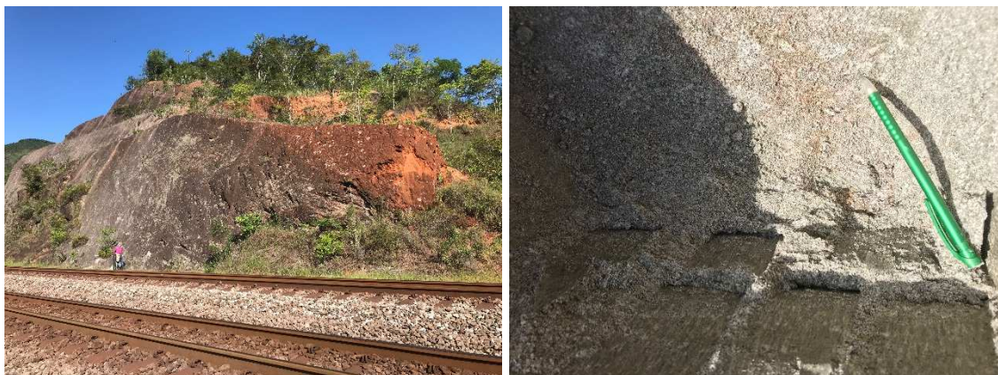
Figura 5.11 – Vista panorâmica do talude do km 521+522 (a esquerda) e em detalhe (a direita)
