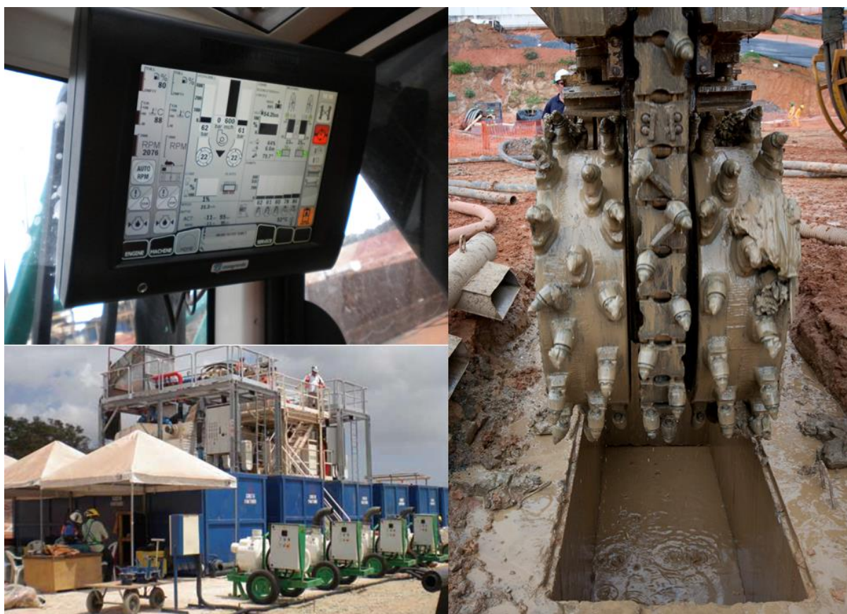
Figura 61 - Detalhe das rodas de corte, do sistema eletrônico de bordo e da recicladora.
