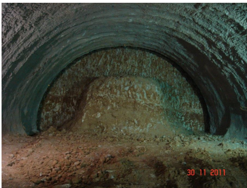
Figura 1 Foto de túnel executado pelo método NATM (Lote 1 – Linha 5 do Metrô SP)
