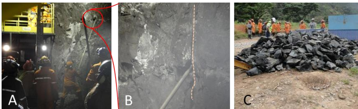
Figura 1: (A e B) Remoção de um bloco nas parede do túnel Naque, Minas Gerais. (C) Conjunto de blocos removidos no mesmo túnel.
