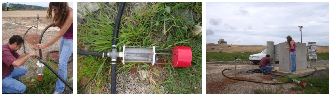
Figura 30 Bifurcação da mangueira para alimentação do biofiltro 2
