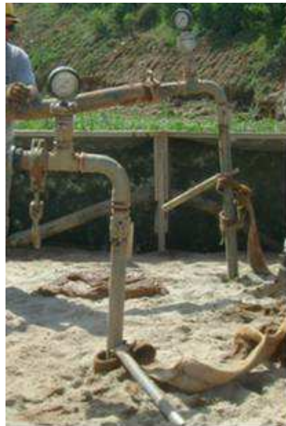
Figura 4.9 - Manômetros instalados na área bombeada
