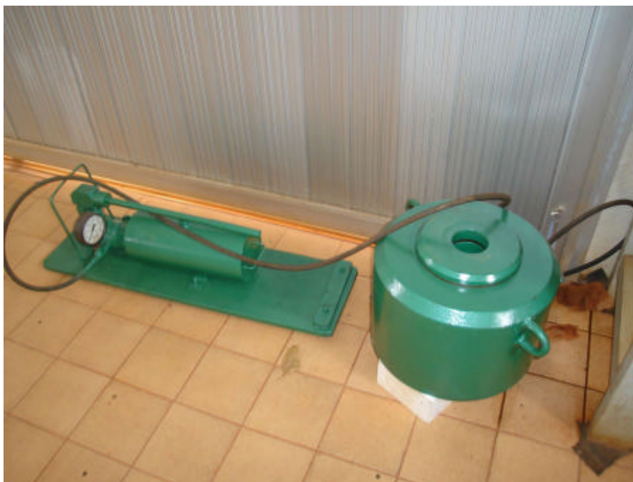
Foto 4.14 – Conjunto bomba-macaco hidráulico.
