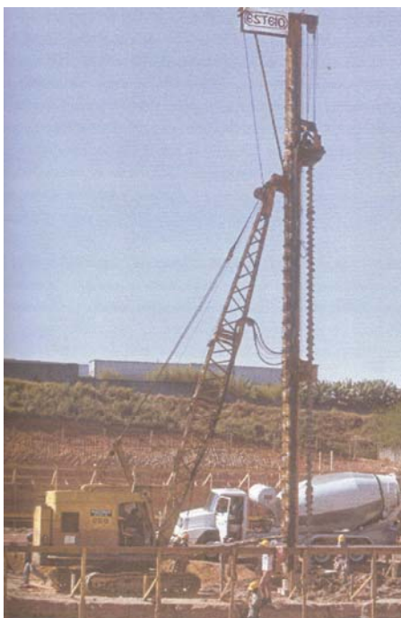
Foto 2.1 – Primeiro equipamento de estacas tipo hélice contínua em operação no Brasil (LÁZARO, 2003).
