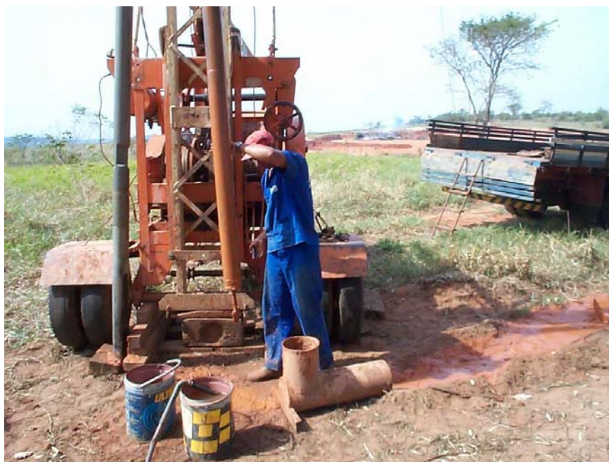
Foto 3.24. Instalação de poço de monitoramento no aterro de resíduos sólidos de Bauru.
