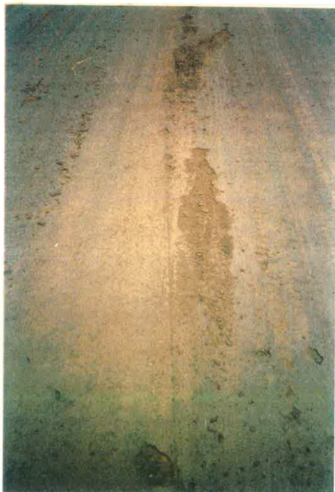
FOTO 6 (ao lado) : Rodovia Descalvado - Usina Sta. Rita. Ruptura da superfície da base, antes de receber o revestimento, por causa do tráfego de obra.
