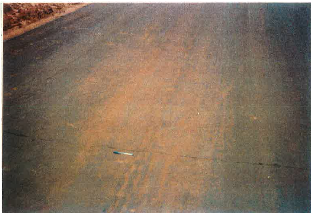
FOTO 5 (acima) : Rodovia Descalvado - Usina Sta. Rita. Pouquíssimas fissuras de contração da base e muito espessadas.
