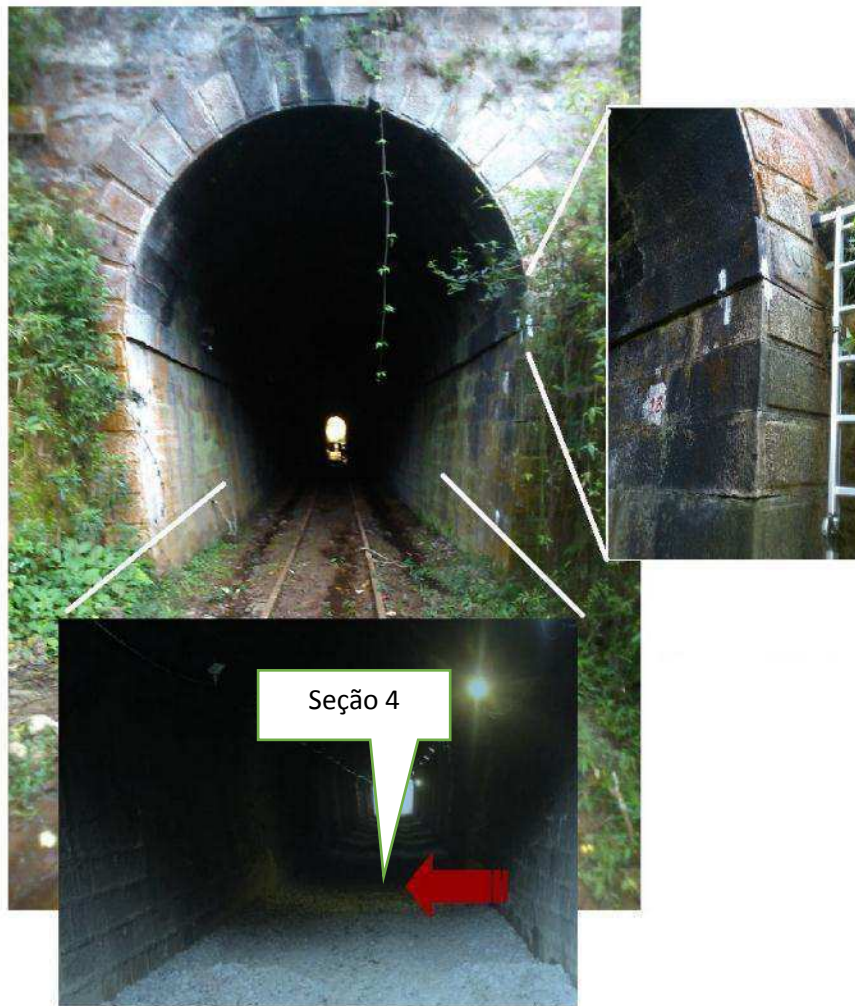
Figura 7-3: Pontos de monitoramento do interior do túnel.
