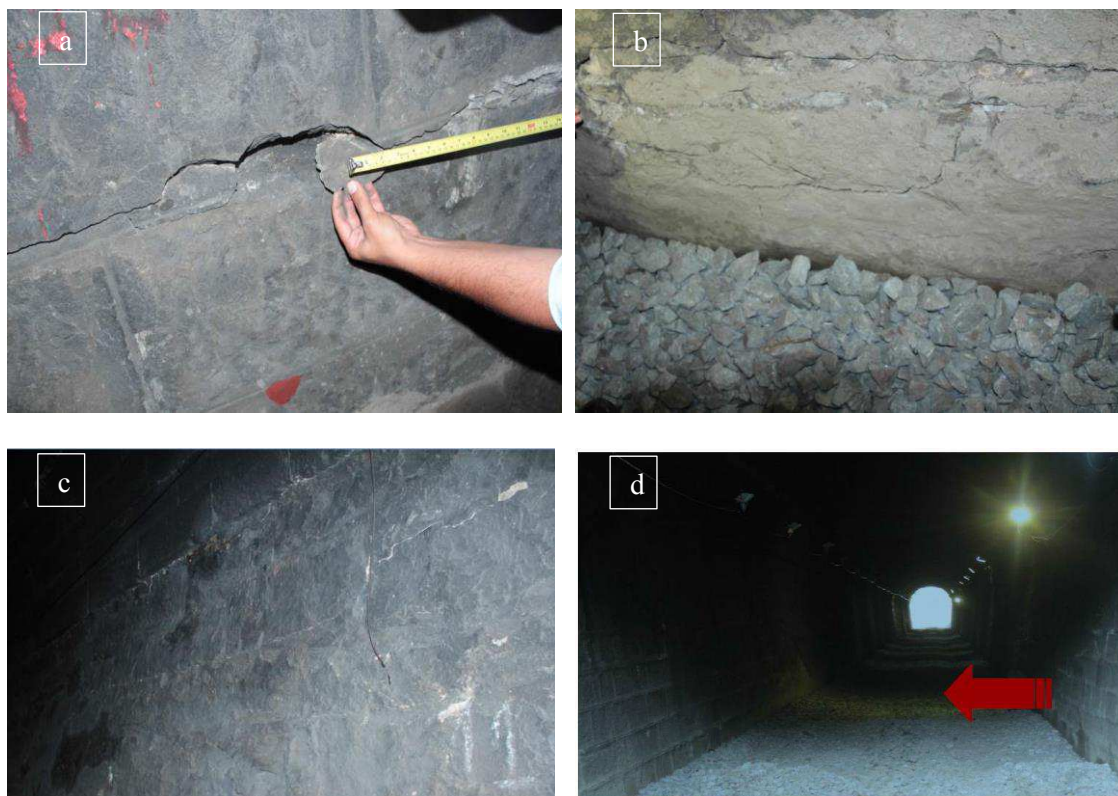
Figura 1-1: Anomalias estruturais encontradas no túnel.
