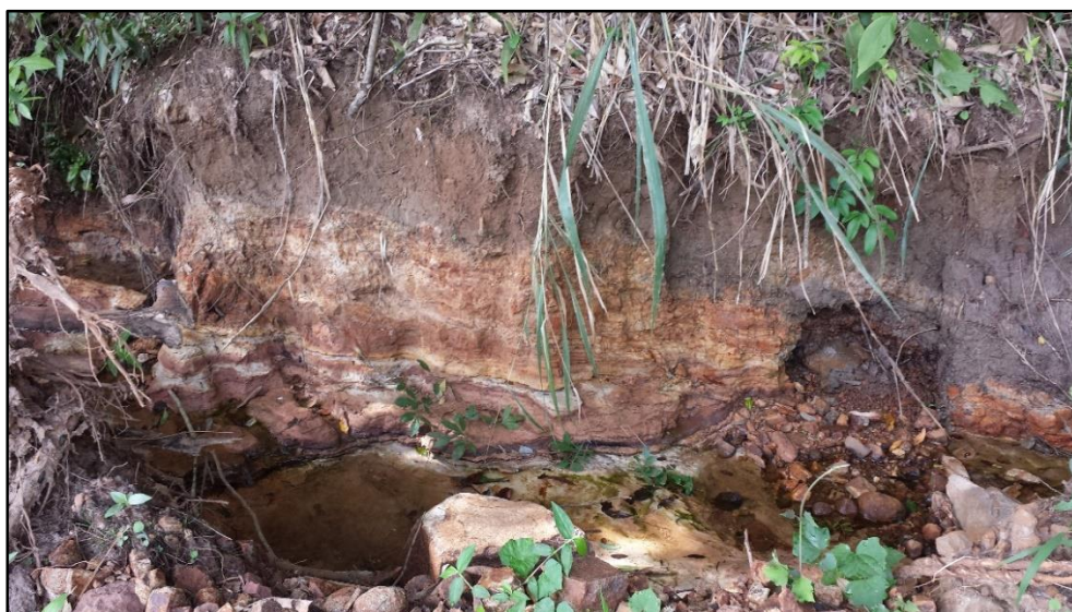
Figura 24. Exemplo da Formação Pirambóia aflorando em um corte de estrada, onde ocorre por conta da presença de níveis mais argilosos nos arenitos uma superfície de difração hídrica.
