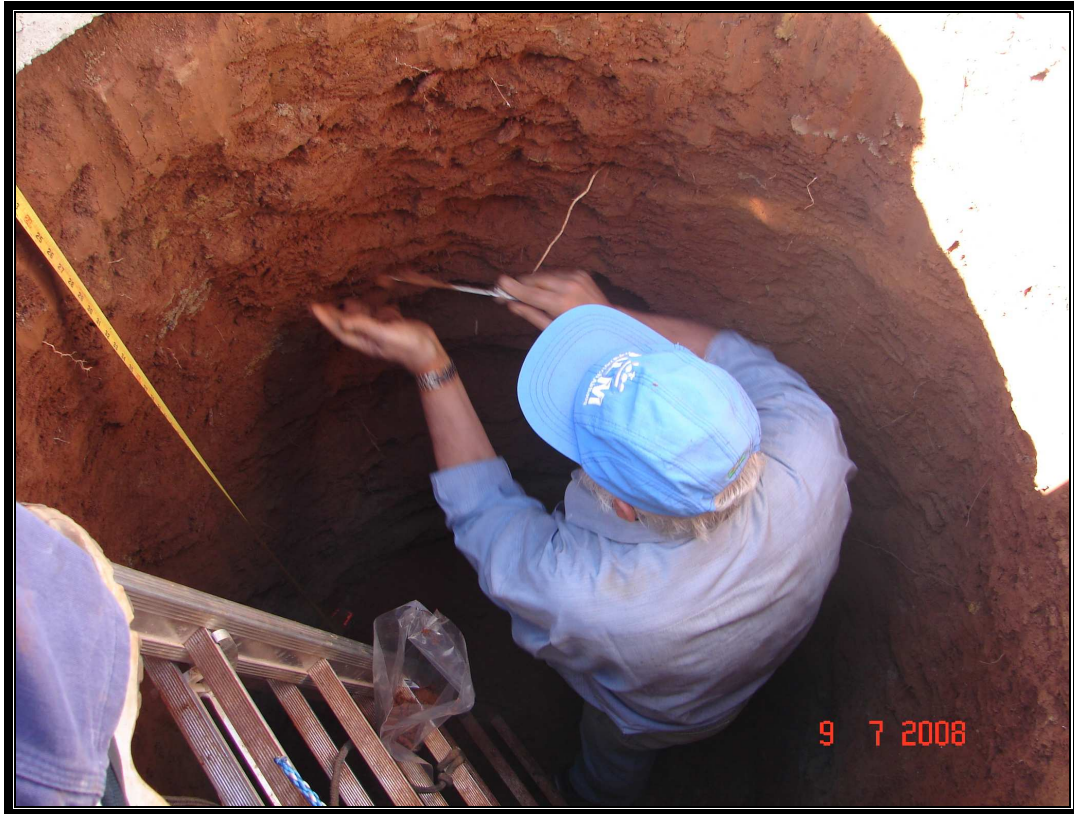
Foto 1 – Análise no interior do poço cacimba de jusante, próximo à “Lagoa Seca”.
