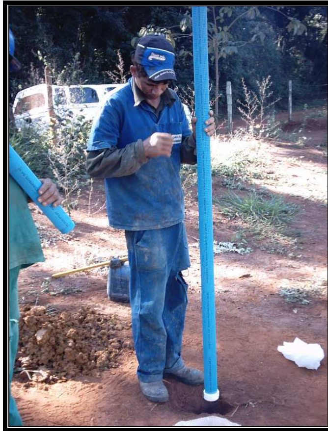
Foto 9 - Instalação do filtro no poço de montante (PM 01) em PVC ranhurado de 2 polegadas.
