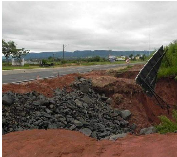
Figura 4.6 – Erosão hídrica às margens da rodovia SP-304 (GLOBO.COM, 2013)
