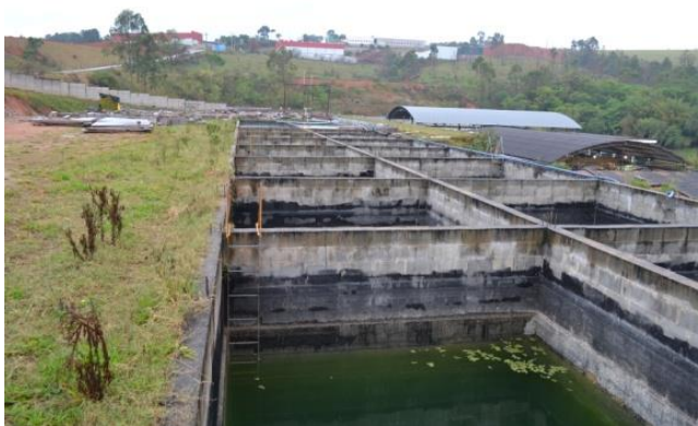
Figura 8 – Tanque de decantação do resíduo para reaproveitamento da água (Arquivo do autor).
