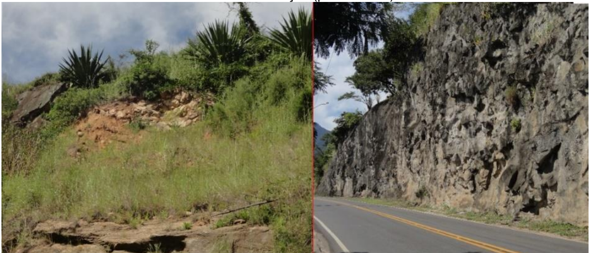
Figura 30: Evidência de escorregamento e queda de blocos em área de corte na estrada. À direita, obra de contenção (pontos 1 e 2).
