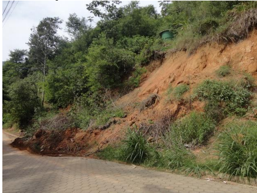
Figura 29: Escorregamento em encosta de morro na beira da estrada (ponto 18).
