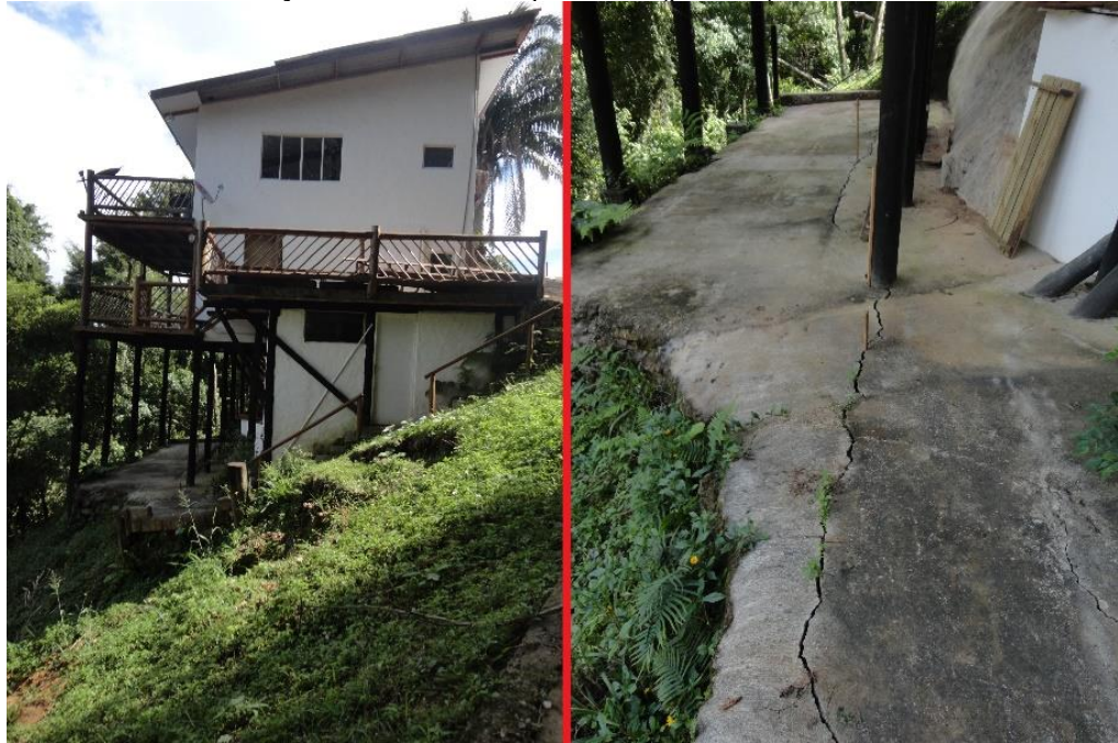
Figura 31: Residência em área de risco de escorregamento. No detalhe, trinca no piso da casa em função do início deste processo (ponto 3).
