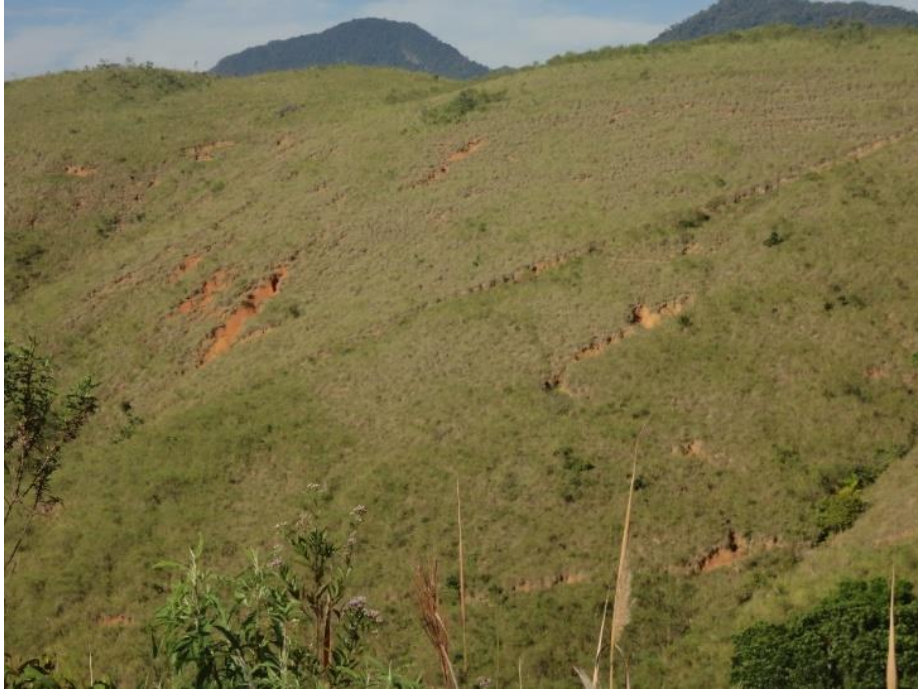
Figura 25: Feições erosivas nas encostas dos morros, neste caso cicatrizes, sulcos e ravinas (ponto 63).
