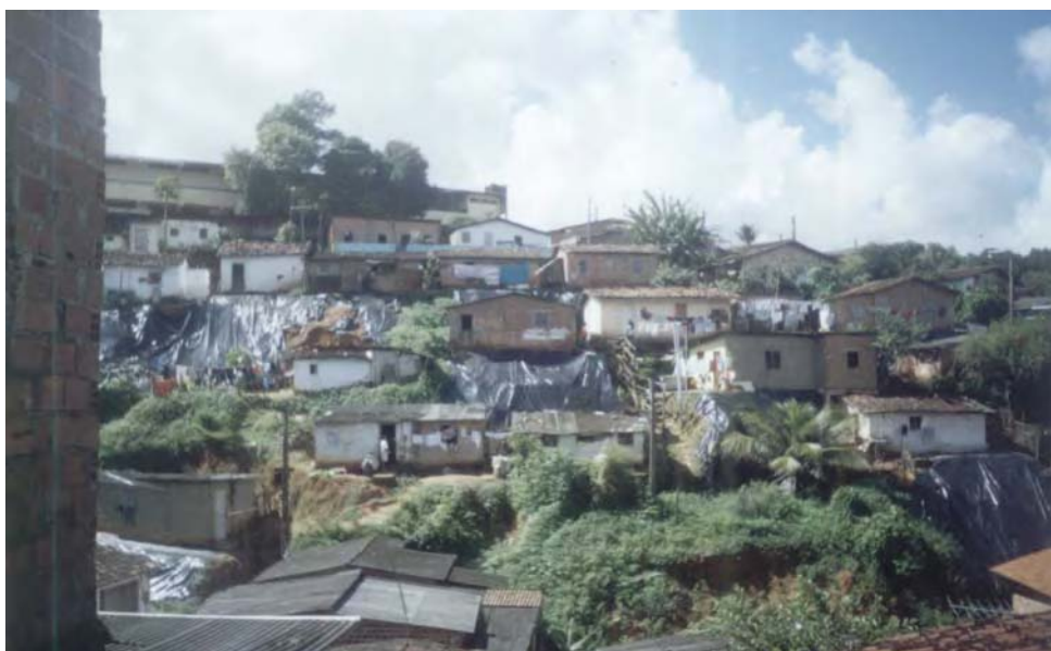
Foto 4.1: Vista do Córrego da Andorinha no município de Camaragibe. Notar as lonas de cor preta que recobrem a encosta para evitar novos deslizamentos
