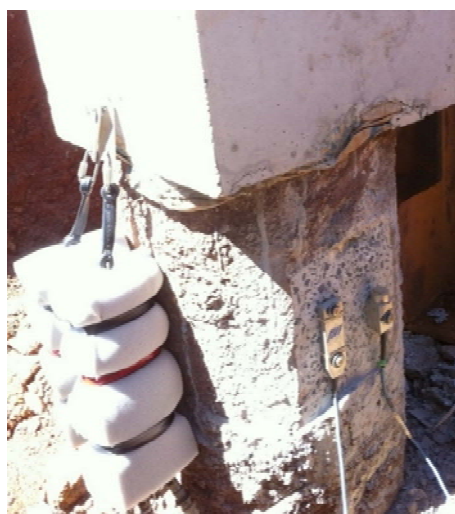
Figura 2.23 – Instalação de defleto e acelerômetro em estaca do tipo hélice contínua (Rosa, 2013).
