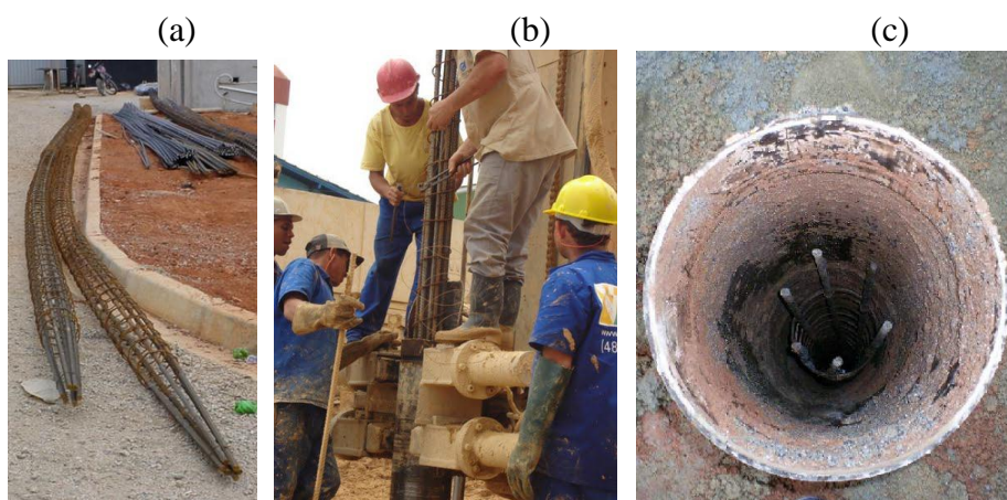
Figura 2.79 (a) armadura (EG BARRETO, 2007); (b) colocação da armadura (NEVES, BIESUZ & VENTURA, 2008) e (c) armadura colocada (LEITE, GIRARDI & SOUZA, 2007).
