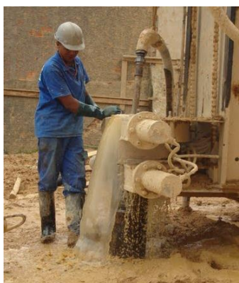
Figura 2.74 Circulação de água (NEVES, BIESUZ & VENTURA, 2008)
