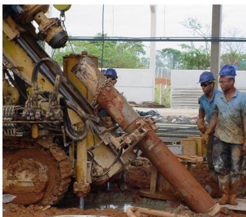
Figura 2.84 Desacoplamento do revestimento com uso de corrente. (EG BARRETO, 2007).
