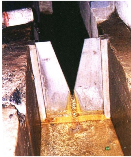
Figura 3.11 – Medidor de vazão triangular com abertura inferior de 30° instalado na barragem de Cana Brava.
