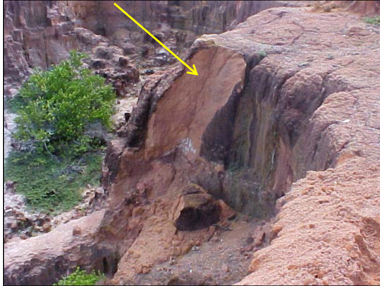
Figura III.25 – Escorregamento de material na encosta sul
